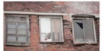
➤ Flügel und Rahmen in desolatem Zustand. Beschläge nicht funktionsfähig. Ungenügende Wärmedämmfähigkeit.
