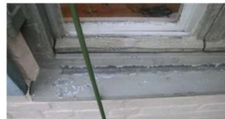
➤ Oberflächen der Flügel und Rahmen sind innen und außen beschädigt. Beschläge reparaturbedürftig.
