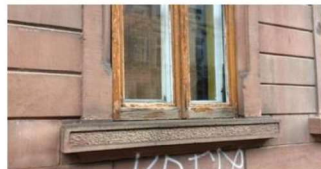
➤ Oberflächen der Rahmen und Flügel sind außen beschädigt. Beschläge in Ordnung.
